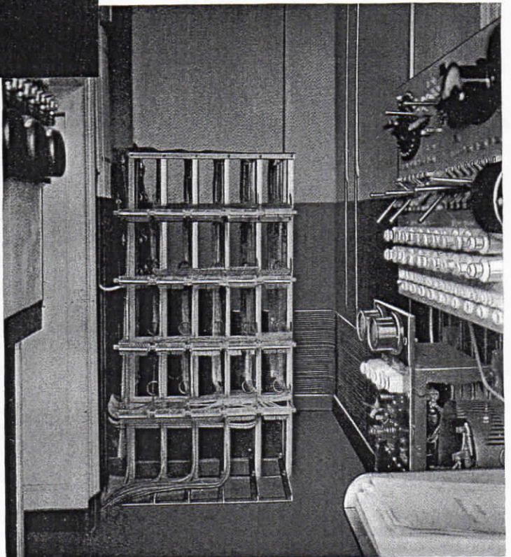
Abb. 7. Haupt- und Rangierverteiler im Bahnhofsgebäude Bebra
