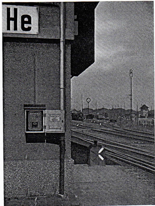
Abb. 14. Feuermelder auf dem Gelände des Hauptbahnhofs Frankfurt a. M.
